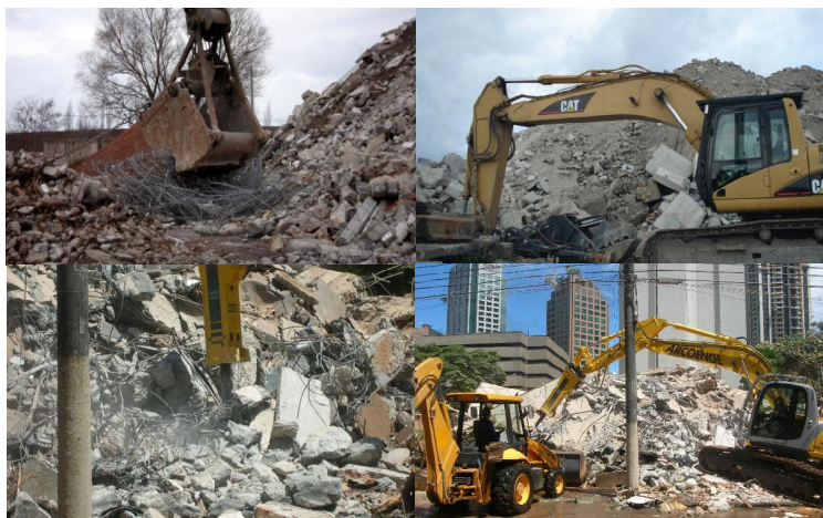
Figura 19 – Bolsas de demolição, caçambas dentadas puxam o aço, rompedores são usados para fragmentar o concreto armado, podem ser manuais ou acoplados em escavadeiras. Fonte: acima fotos de Sérgio C. ngulo [33], abaixo fotos de Carina Ulsen.
