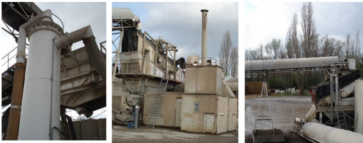
Figura 32 - Captação de material particulado em usina de reciclagem em Berlim, na Alemanha. Fonte: Angulo et al. [33]
