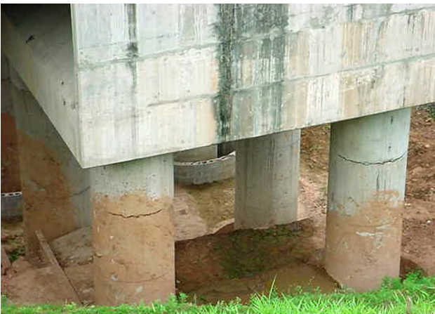
Figura 14.23. Pilar do viaduto VD-7 mostrando fissura no km 58 da pista descendente da SP-160 Rodovia dos Imigrantes. Foto: Amarilis L.C.F. Gallardo.
