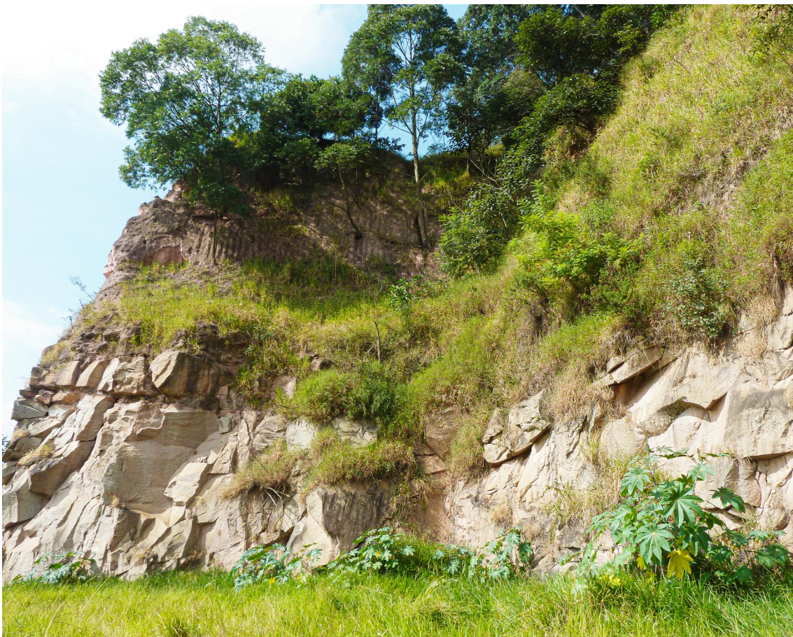
Figura 6.1. Frente de lavra em pedreira desativada, mostrando rocha fresca na base (granito fraturado), coberto por manto de intemperismo. Pedreira Itaquera, São Paulo, SP. Foto: Eliane A. Del Lama.
