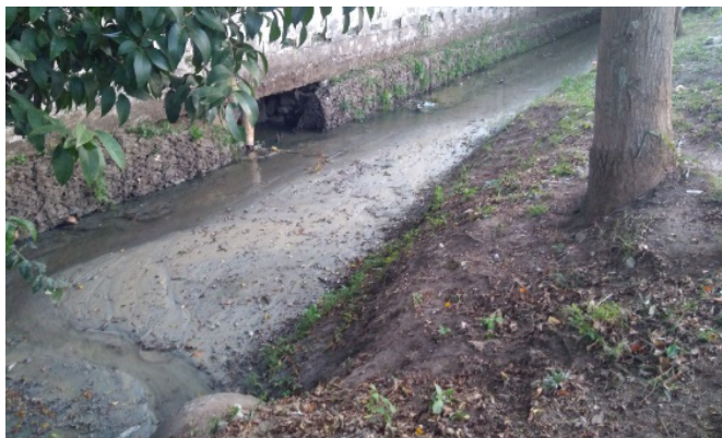
Figura 6 - Assoreamento em trecho do córrego Tenente Rocha
