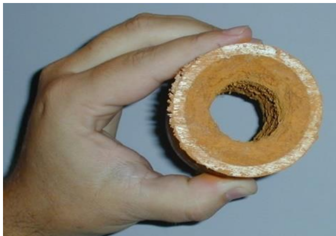
Figura 11. Entupimento por precipitados de ferro.
