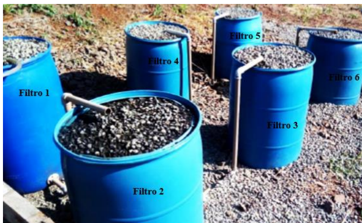
Figura 10. Sistema de biofiltração composto por seis filtros anaeróbios verticais confeccionados em tambores plásticos (PITORO, 2019).
