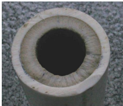
Figura 10. Tubo PVC (1 ½ pol) com um ano de uso parcialmente entupido por cristais de carbonato de cálcio.
