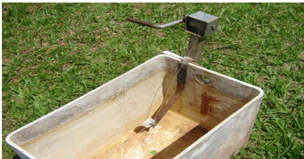
Figura 5. Detalhe da roldana e do estecedor, adaptado com uma manopla para facilitar a operação, instalados na caixa de recepção.
