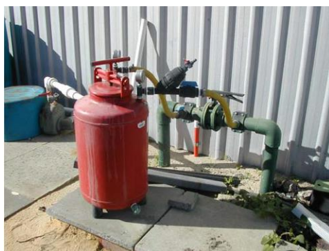
Figura 6. Tanque de injeção de fertilizantes.
