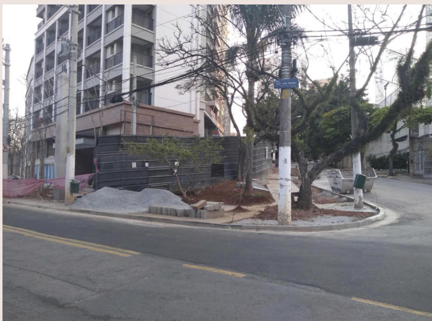
Figura 11 Obra na calçada sem alternativas para o deslocamento seguro do pedestre, fazendo com que este caminhe ao longo do leito viário, sem proteção e segregação, aumentando riscos de atropelamentos.
