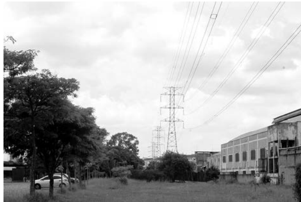
FIGURA 17 Linha de alta tensão nas imediações do Parque da Juventude, 2018: trecho da linha de alta tensão existente que deverá ser apoio para a implantação da Estrutura de Contorno/ Linha Norte.
