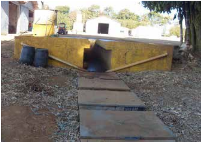
Sistema de coleta e separação de água/óleo, em local de lavagem de maquinários
