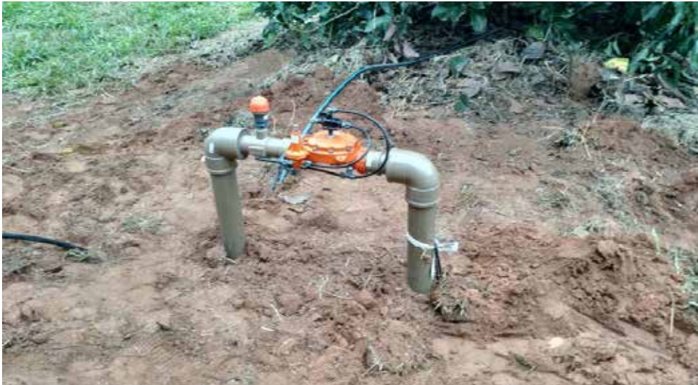
Cavalete com válvula de comando hidráulico
