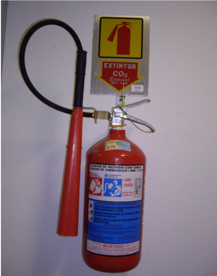
Figura 6. Extintor de incêndio
