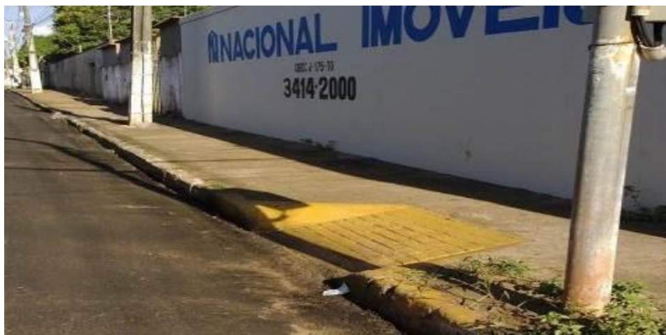
Foto 03 – Calçada irregular II.
