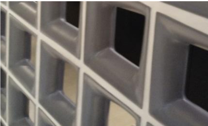
FIGURA 20: Elementos vazados em cerâmica
