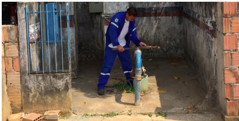
Figura 7.3 – Bombeamento do poço direto para a rede.
