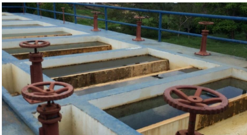
Figura 7.8 - Estação de Tratamento de Água de São Francisco (ETA São Francisco).
