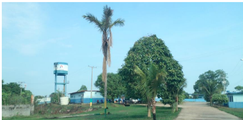
Figura 7.7 – Estação de Tratamento de Água de São Francisco (ETA São Francisco).
