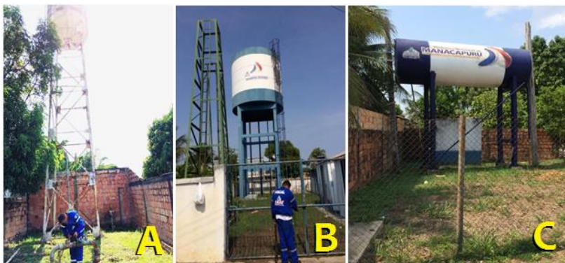
Figura 7.4 – Reservatórios: A = metálico; B = de concreto; e, C = de fibra de vidro.
