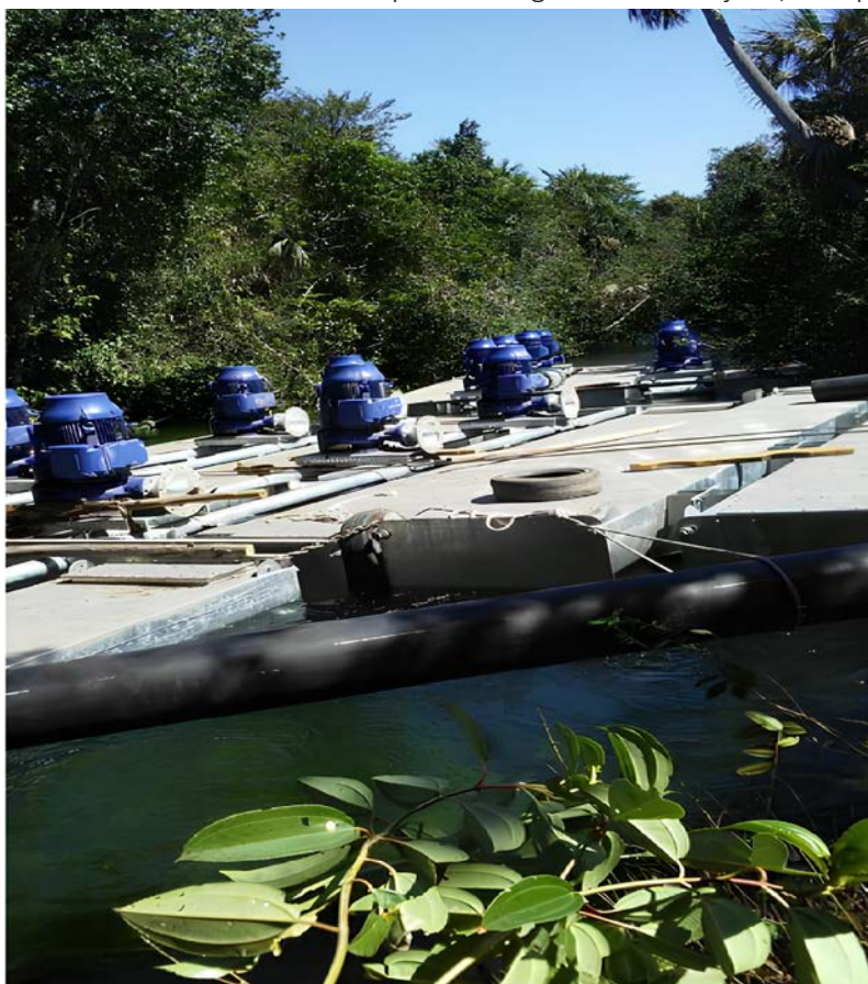
Foto 3 – Sistema de motobombas que retira água do rio Arrojado, à esquerda
