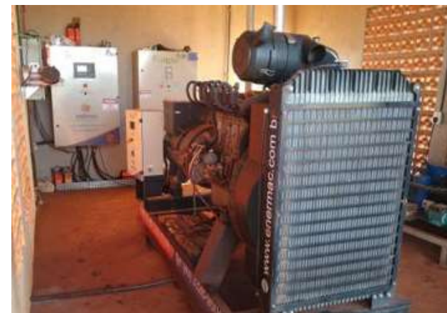
Grupo gerador a biogás, Toledo (PR).
