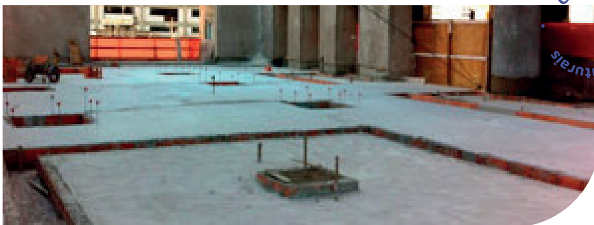
Figura 38 – Concreto de enchimento usado para nivelar áreas externas de edifícios. Fonte: google imagens.
