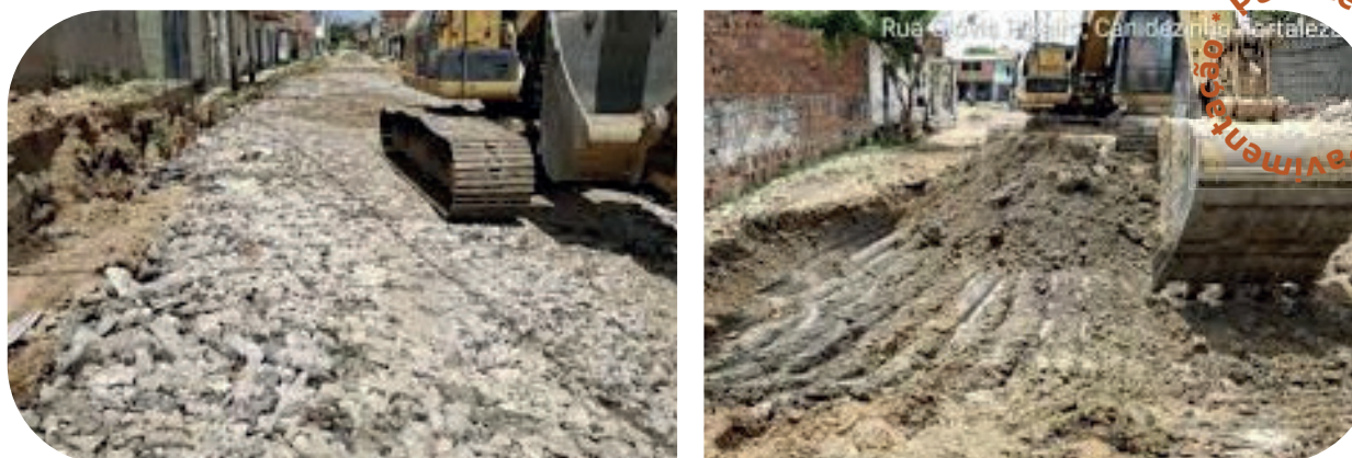
Figura 19 – Obra de pavimentação: escavação do solo local e reforço do subleito com rachão reciclado misto. Fonte: [35]
