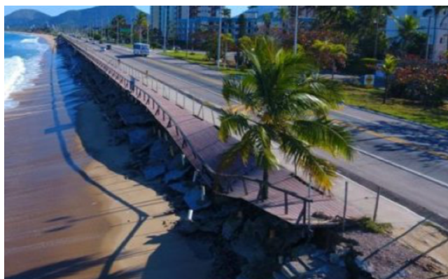
Fig. 3.5 - Deck de madeira construído sobre enrocamento na praia de Massaguaçu e danificado pela ação das ondas. Fonte: Ubatuba acontece
