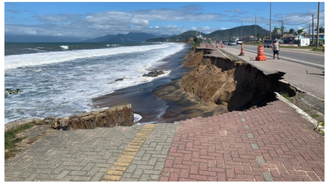
Fig. 3.3 - Erosão destruiu calçada e invadiu pista da Rio-Santos na praia de Massaguaçu, litoral norte de São Paulo. (Foto: João Mota/ TV Vanguarda)
